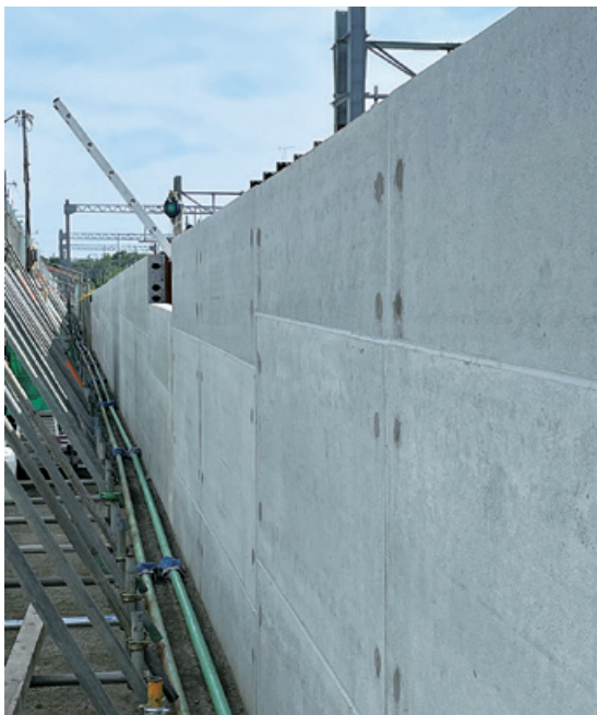
〈土留め壁〉 スパンクリートの耐久性と美観が評価され、床板が土留め壁として採用されました
